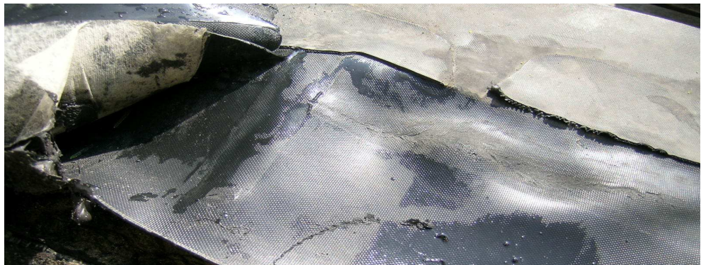
EPDM: Undichtigkeiten unterhalb Reparaturversuch
