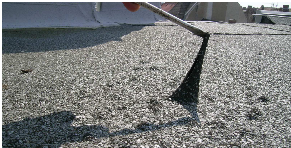
Blasen-Pockenbildung bei neu verlegter Polymerbitumenbahn
