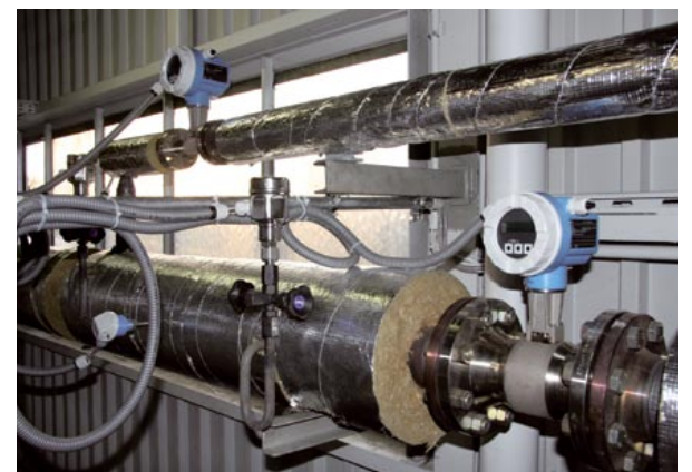
Je nach Produktionsauslastung wird der Dampf durch eine der beiden Messstrecken mit unterschiedlicher Nennweite geführt und von den Prowirl Durchflussmessgeräten erfasst.
