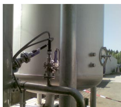
Die pH-Messung am Neutralisationstank
