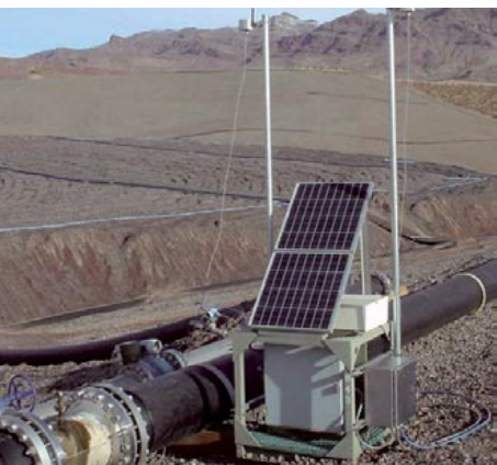
Eine der solarbetriebenen Messstellen mit Promag und Cerabar auf der Mine.
